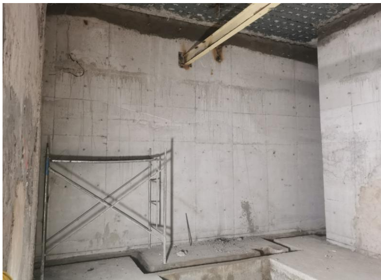
图8-1 加速器机房内部
