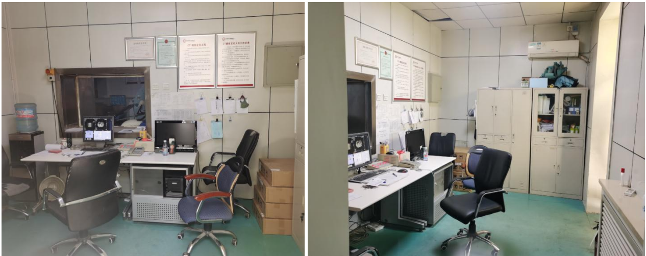
图8-8 后装治疗机房控制室
