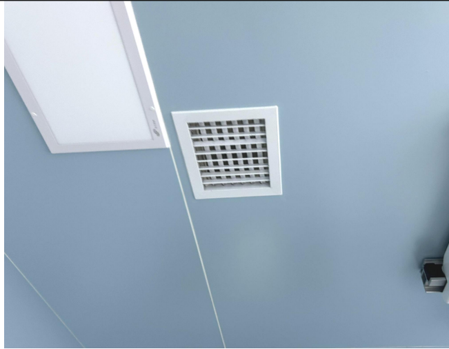
图3-13 DSA机房排风口照片
