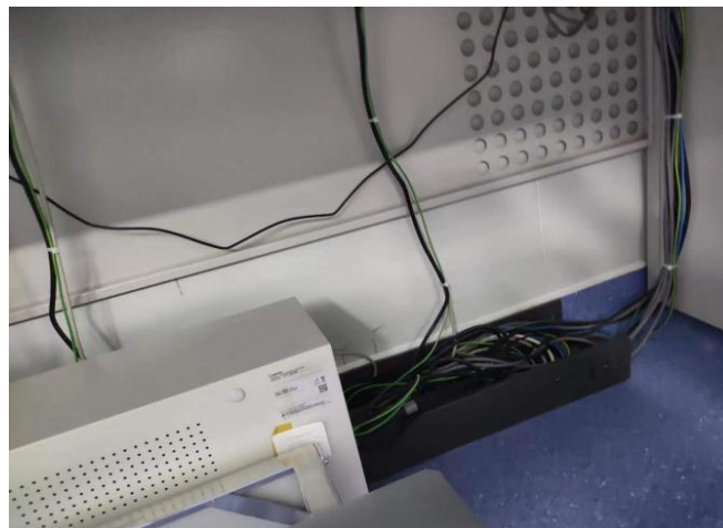
图 3-2 DSA 机房管线穿墙照片
