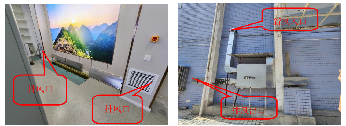
图 6-1 机房内排风口
