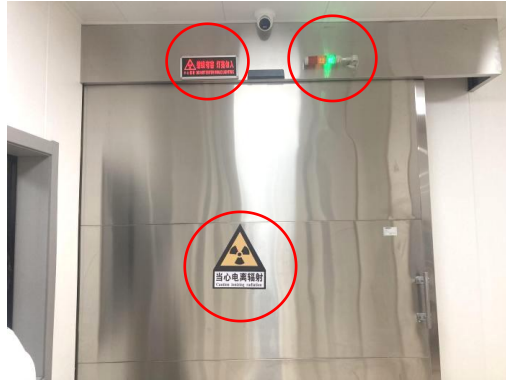
图 5-9 电离辐射警告标志和工作状态指示灯
