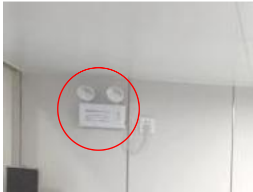
图 5-10 机房迷路处的应急照明
