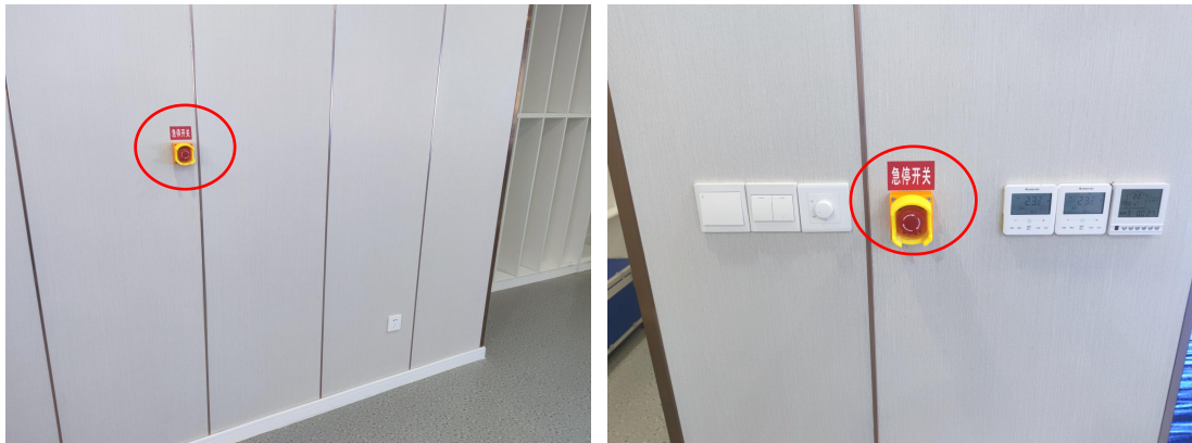
图 5-5 机房北墙和迷路内墙上的急停开关照片
