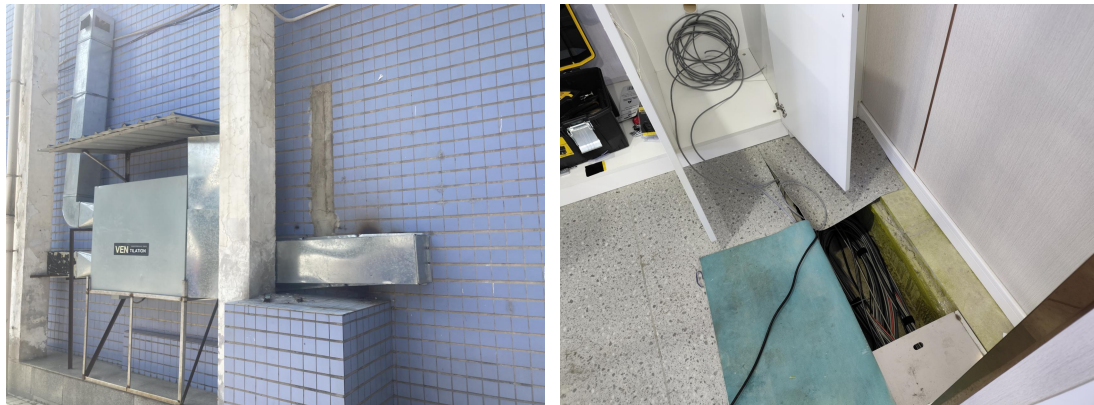
图 5-4 机房通风管道和管线地沟照片
