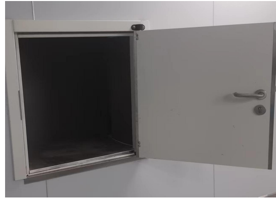
图 3-11 DSA 机房污物传递窗照片
