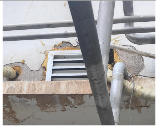
图3-13 DSA机房外通风口照片
