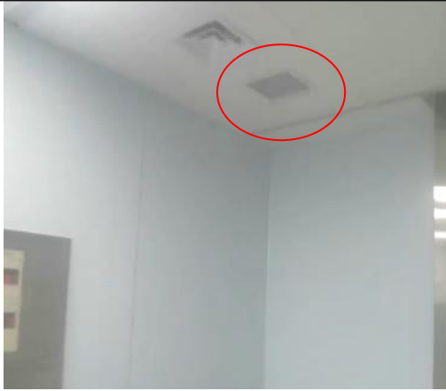
图3-12 DSA机房内通风口照片
