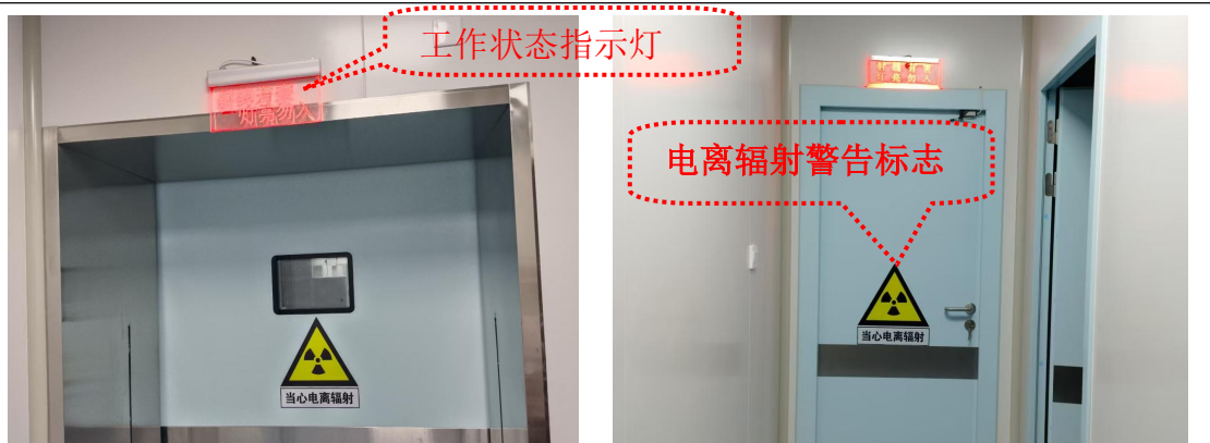
图 3-9 DSA 机房受检者防护门
