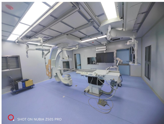
图 3-1 DSA 机房内部
