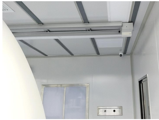
图 3-6 机房内视频监控装置
