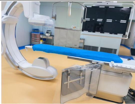
DSA 机房辅助防护设施
