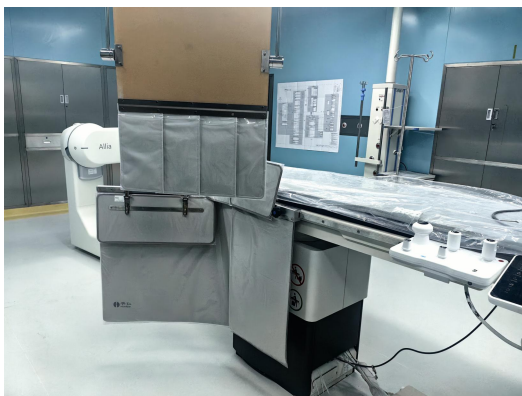
DSA 机房辅助防护设施
