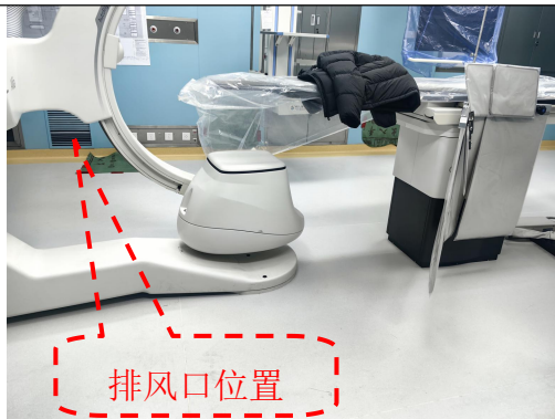
DSA 机房排风口
